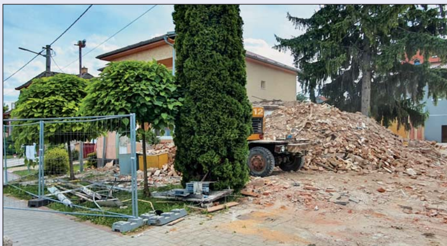
● Z časti budovy bývalého MNV ostala iba kopa tehál a dreva
