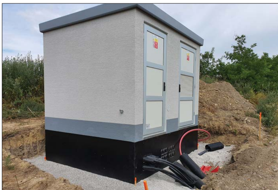
● Nová transformačná stanica na Záhumenskej ulici
