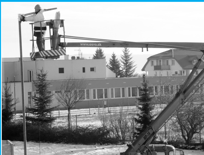
● Výmena starých svietidiel za nové zníži spotrebu elektrickej energie o polovicu.
