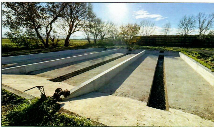
• Zrekonštruované kalové polia
