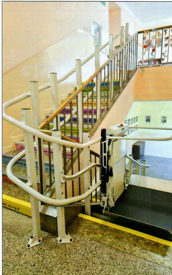
● Plošina pre telesne postihnuté osoby, ktorú obec zakúpila, je nainštalovaná od suterénu až na najvyššie podlažie budovy školy
